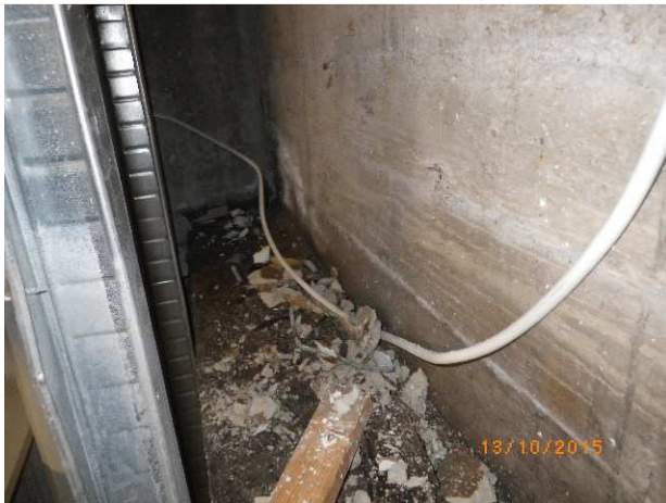
Seinän välissä purkujätettä
